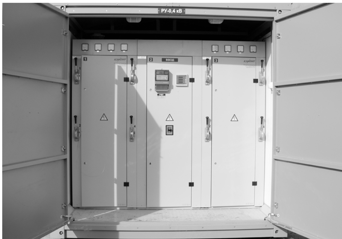
Рисунок 3.2.4 Отсек распределительного устройства низкого напряжения
