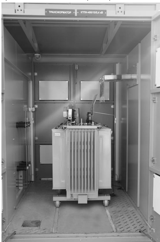
Рисунок 3.2.7 Отсек силового трансформатора
